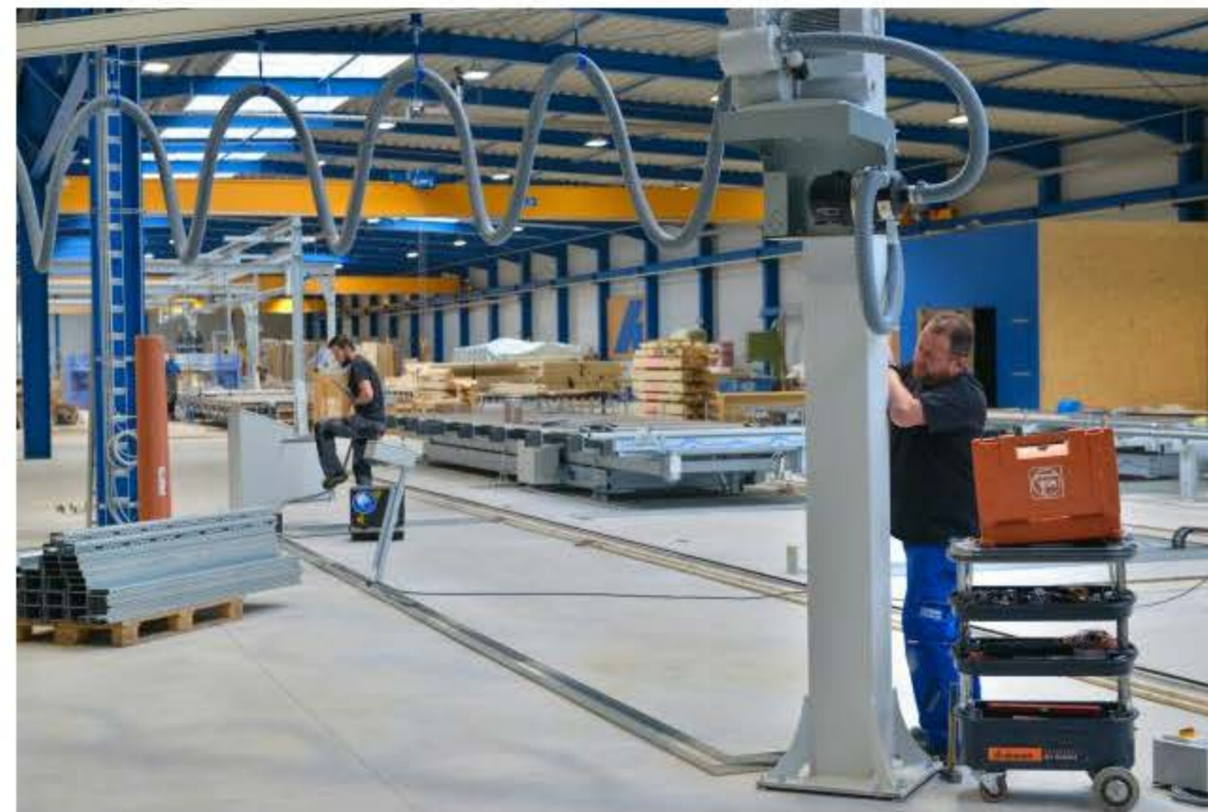
Aufbau der neuen Weinmann-Anlage: Für die automatisierte Deckenfertigungslinie wurden im Juli in Burg neue Schienen verlegt und Versorgungsleitungen installiert (Foto: Schnoor)
