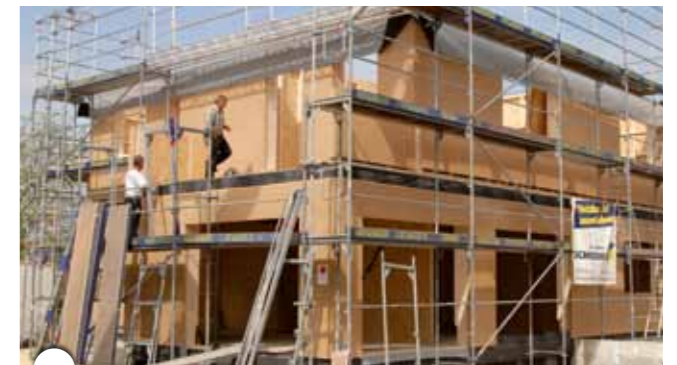
Dank des hohen Vorfertigungsgrades war der Rohbau des Effizienzhauses in nur 2 Tagen komplett montiert.
